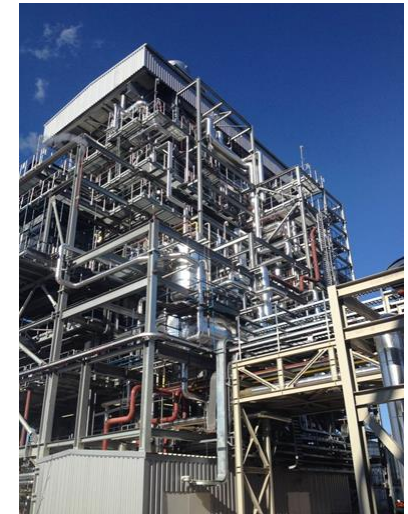
Biomassekessel Pemuco, Chile
