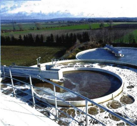
Werk Rain, Nitrifikation/Denitrifikation
