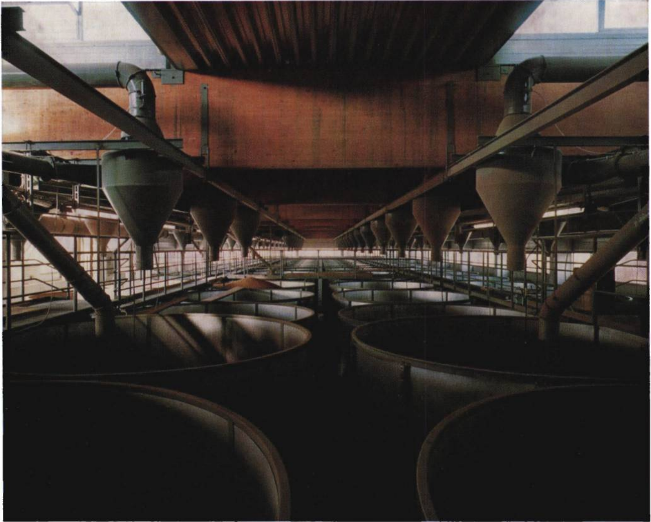
Blick in das Getreidelager der Saatgutaufbereitungsanlage Offenau. Reinigung, Sortierung, Beizung und Absackung des Getreides erfolgen vollautomatisch.
